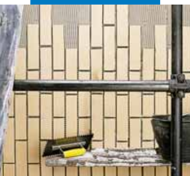
Assentamento em parede no exterior
