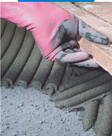
Assentamento de tijoleira sobre betonilha incoerente
